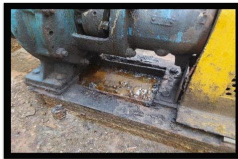
Gambar 4.9 Baseplate Motor Dan Pompa Terkorosi ( Sumber Dokumentasi Pribadi )
