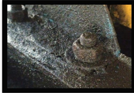
Gambar 4.10 Baut Pengikat Pompa Motor Dan Pompa Terkorosi ( Sumber Dokumentasi Pribadi )
