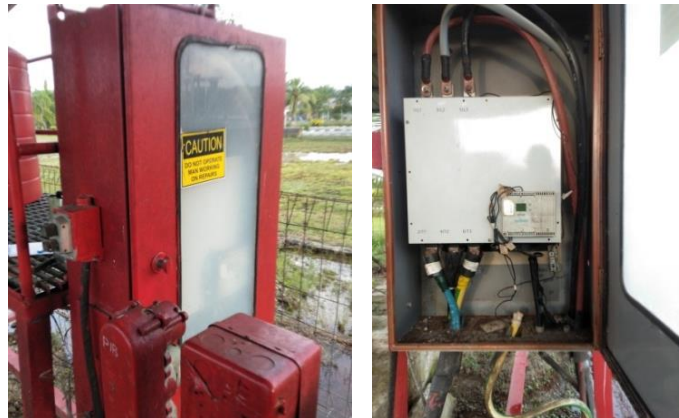
Gambar 3.6 Panel kontrol untuk motor listrik fire pump P2
