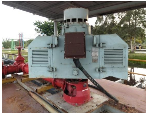
Gambar 3.1 Motor listrik Fire Pump P2 Sumber : data olahan
