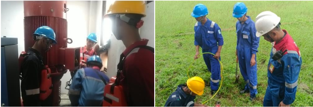
Foto : Kerja Praktek Pengukuran Insulator Fire Pump Jetty 2 dan Pemasangan kabel grounding pada tangki kilang
