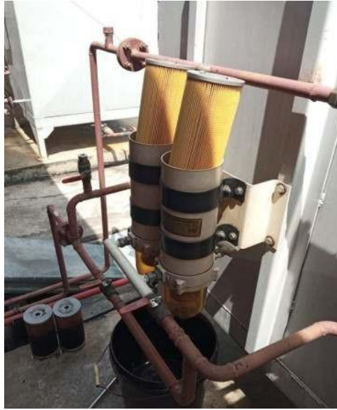
Gambar 4.6.3 filter yang kotor Sumber: PT. PLN (Persero) PLTD II Bengkalis
