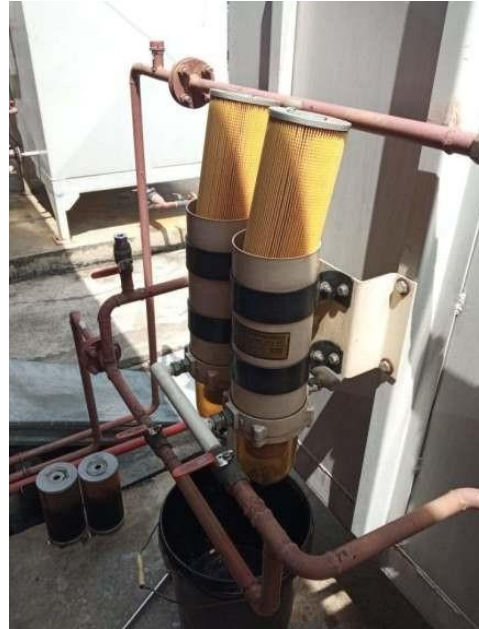
Gambar 4.6.5 bagian dalam rumah filter bersih, masukkan filter minyak yang baru ke dalam rumah filter sebanyak 2 buah Sumber: PT. PLN (Persero) PLTD II Bengkulu
