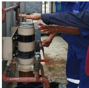
Gambar 4.6.6 tutup rumah filter pada racor Sumber: PT. PLN (Persero) PLTD II Bengkulu
