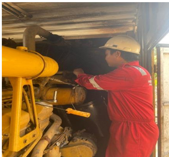
Gambar 4.6.2 tutup rumah filter pada racor Sumber: PT. PLN (Persero) PLTD II Bengkulu
