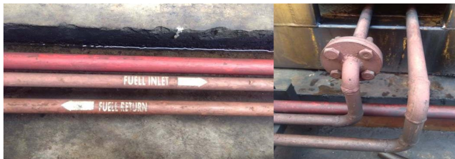
Gambar 4.4.6 Return Line/Overflow Line Sumber: PT. PLN (Persero) PLTD II Bengkalis
