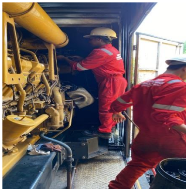
Gambar 4.6.5 pasang penutup fuel filter menggunakan kunci yang sudah disediakan Sumber PT. PLN (Persero) PLTD II Bengkalis
