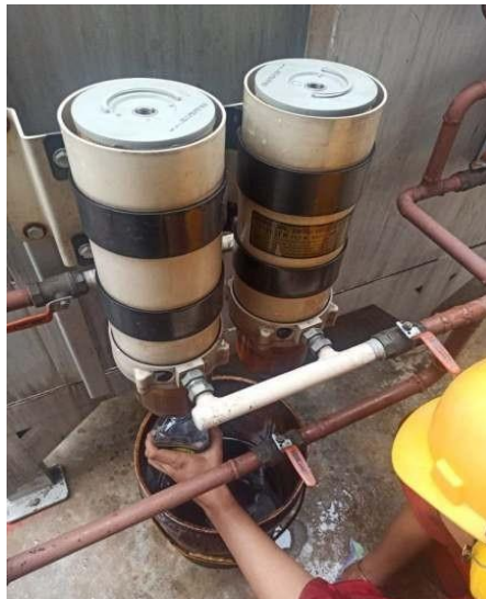
Gambar 4.6.2 tutup rumah filter pada racor Sumber: PT. PLN (Persero) PLTD II Bengkalis
