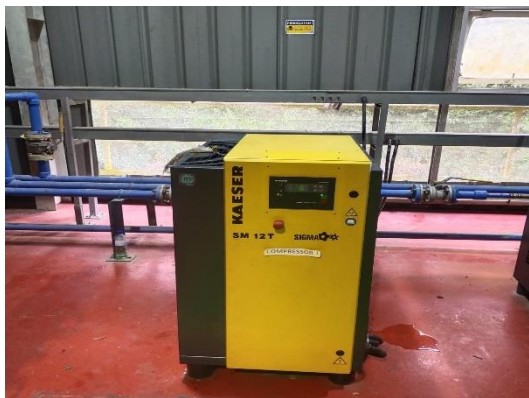
Gambar 4.2 Mesin Kompresor KAESER SM 12T
