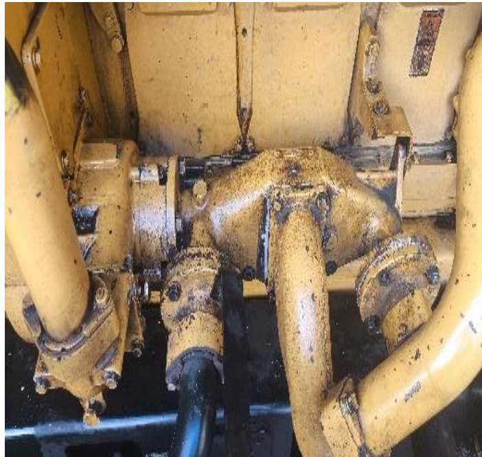
Gambar 4.7 saluran pipa dan auxiliary pump
