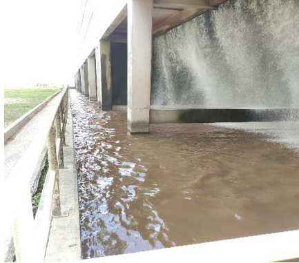
Gambar 4. 11 cooling tower Sumber: Dokumentasi pribadi
