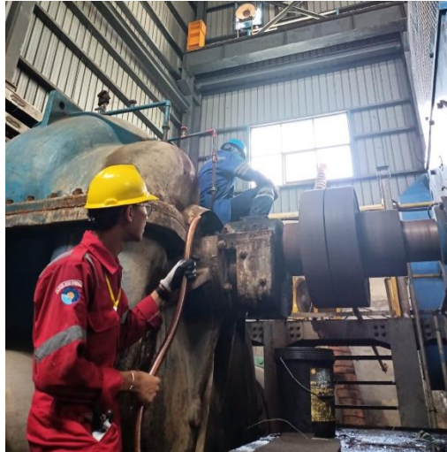
Gambar 3. 3 Penambahan oli pada pompa CWP Sumber: dokumentasi pribadi
