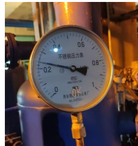
Gambar 4. 10 pressure setelah cleaning Sumber: Dokumentasi pribadi
