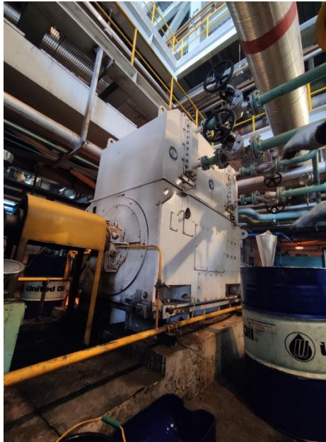
Gambar 3. 1 Pompa BFP ( Boiler Feed Pump ) Sumber: dokumentasi pribadi
