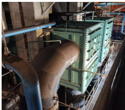
Gambar 4. 2 Condensor Sumber: Dokumentasi Pribadi
