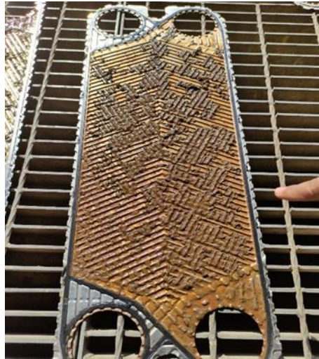
Gambar 4. 13 Plate Heat Exchanger yang kotor Sumber: Dokumentasi pribadi
