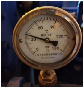
Gambar 4. 9 temperatur warm out Sumber: Dokumentasi pribadi
