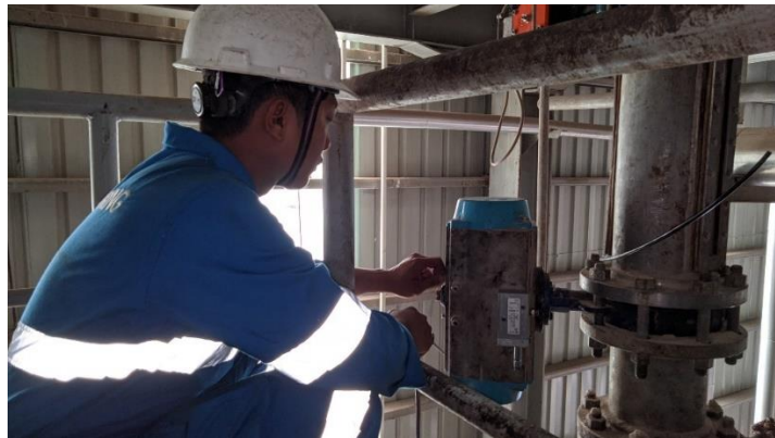
Gambar 2. 23 Pemasangan Indicator dan solenoid actuator valve 212B di plan refinery 2 (Sumber: Dokumentasi, 2024)
