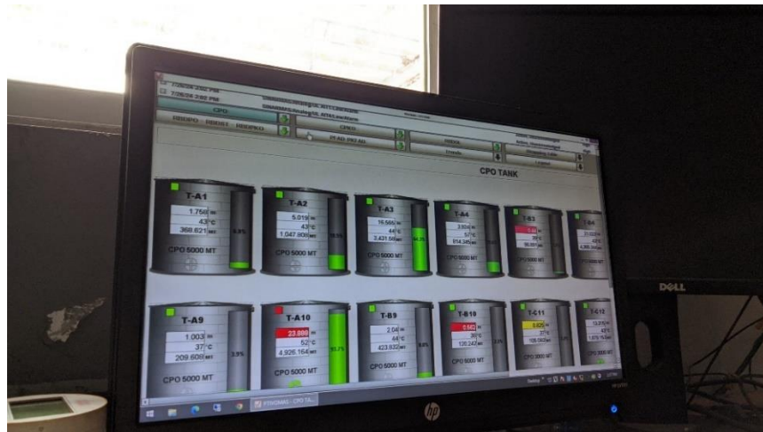
Gambar 2. 5 Monitoring pada Tank Farm melalui Scada di ruangan server ATG (Sumber: Dokumentasi, 2024)
