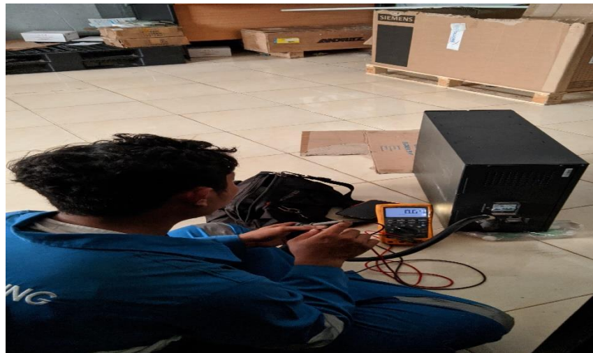
Gambar 2. 31 Pengecekan Baterai UPS di Ruang ATG ( Automation Tanki Gauge ) Tanki Farm . (Sumber: Dokumentasi, 2024)
