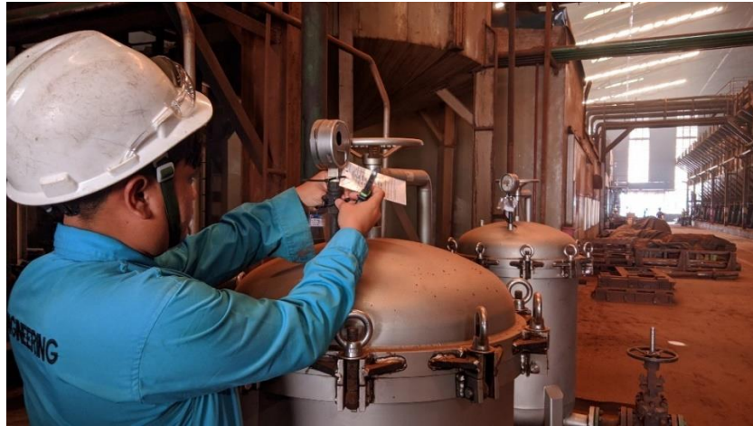
Gambar 2. 3 Pemasangan Tagging Calibration pada Tanki FLCCP Filter Leave di plan KCP ( Kernel Crusing Plant ) Sumber: (Dokumentasi, 2024)
