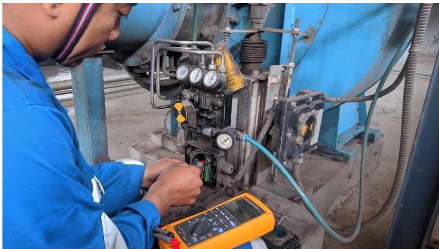
Gambar 2. 4 Pengecekan Positioner ED FAN A di plan HPB ( High Pressure Boiler ) (Sumber: Dokumentasi, 2024)
