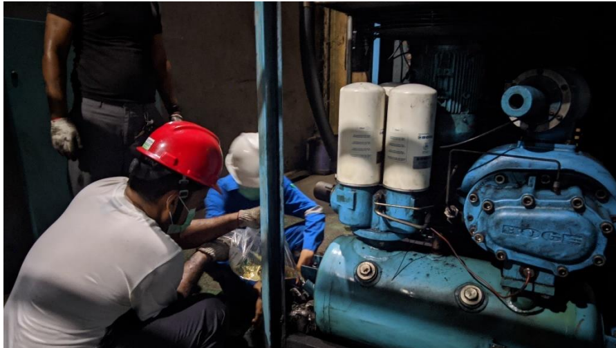
Gambar 2. 9 Penggantian oil cooler pada compressor di plan LPB ( Low Pressure boiler ) (Sumber: Dokumentasi, 2024)
