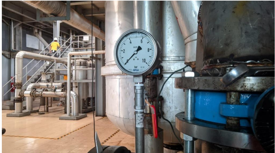
Gambar 2. 11 Pemasangan pressure gauge 10 Bar dan safety valve washing di plan refinery (Sumber: Dokumentasi, 2024)
