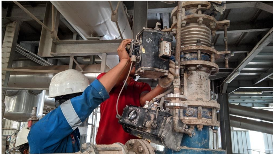
Gambar 2. 24 Pengecekan Aktuator V631BA di plan refinery 1 (Sumber: Dokumentasi, 2024)
