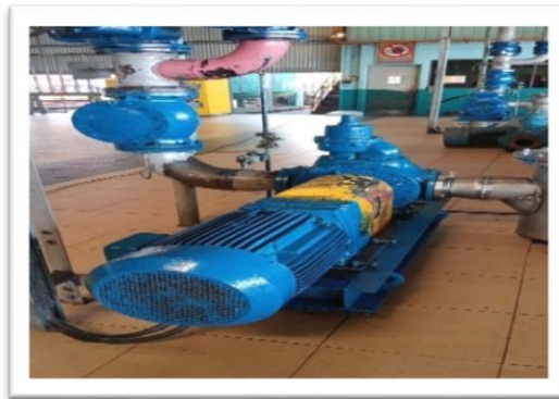
Gambar 4.1 Pompa Blackmer. (Sumber : pribadi)
