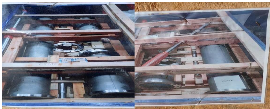
Gambar 4. 3 Komponen-Komponen Utama Fire Pump 717-PE-3
