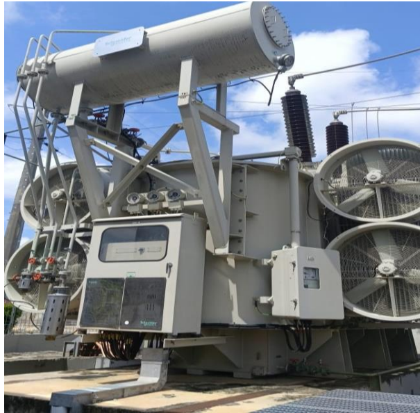
Gambar 3.6 Transformator Daya (Sumber : Dokumentasi, 2024)
