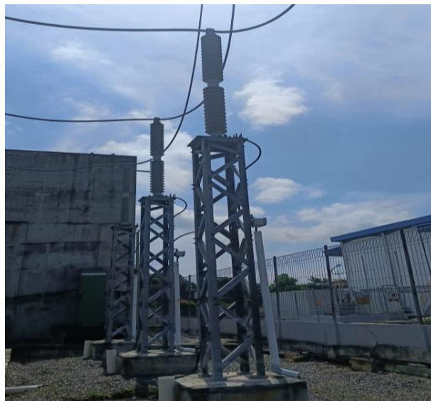
Gambar 3.1 Lightning Arrester (Sumber : Dokumentasi, 2024)
