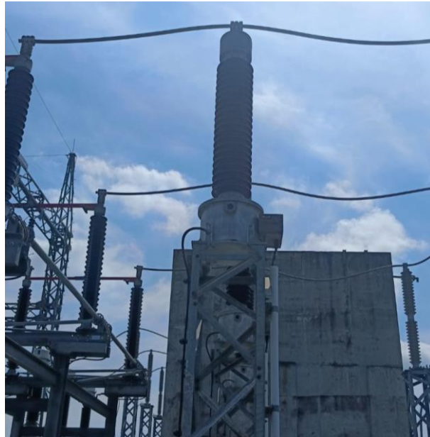
Gambar 3.2 Capasitif Voltage Transformer (Sumber : Dokumentasi, 2024)
