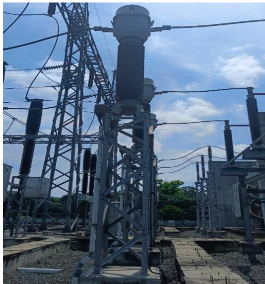
Gambar 3.4 Current Transformer (Sumber : Dokumentasi, 2024)
