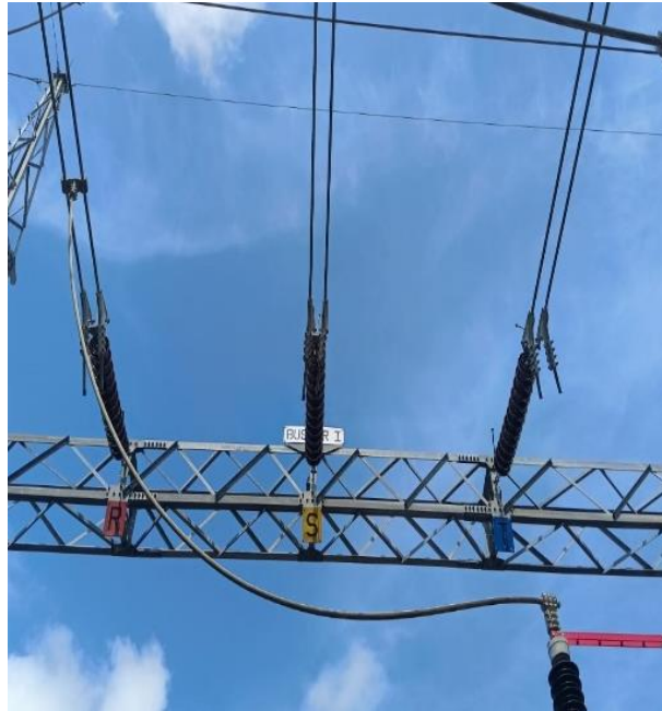
Gambar 3.8 Busbar (Sumber : Dokumentasi, 2024)
