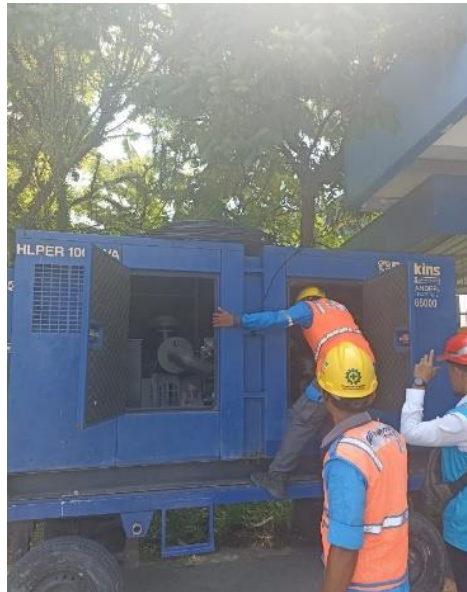
Gambar 2. 51 Pengeeckan dan Siaga Genset Sumber: (Dokumentasi Pribadi, 2024)
