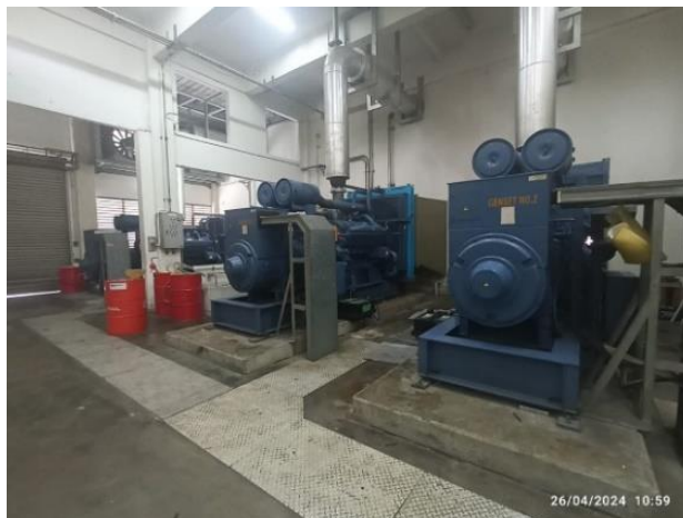
Gambar 2. 38 Pengecekan dan Pemeriksaan Genset Sumber: (Dokumentasi Pribadi, 2024)
