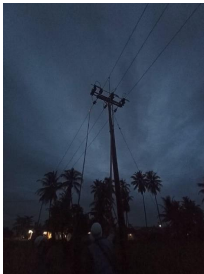
Gambar 2. 12 Pengecekan Fasa - Fasa Sumber: (Dokumentasi pribadi, 2024)
