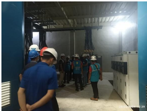
Gambar 2. 55 Pengecekan Kubikel PT.Charoen Sumber: (Dokumentasi Pribadi, 2024)
