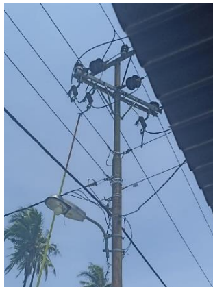
Gambar 2. 8 Pemutusan Fuse Cut Out (FCO) Sumber: (Dokumentasi pribadi, 2024)
