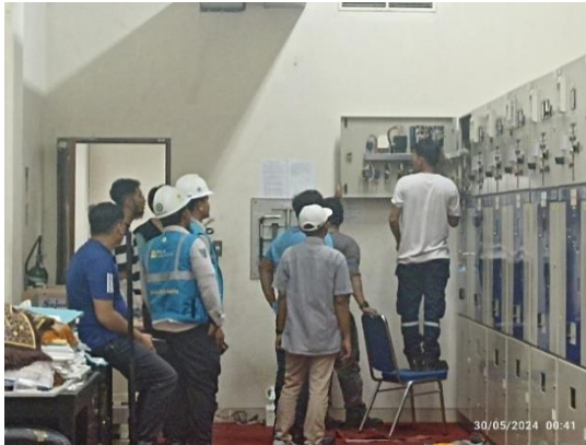
Gambar 2. 56 Pengecekan Kubikel PT Angkasa Pura Sumber: (Dokumentasi Pribadi, 2024)
