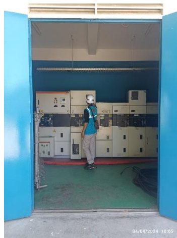
Gambar 2. 32 Pemeriksaan Instalasi dan Genset di BIM Sumber: (Dokumentasi Pribadi, 2024)
