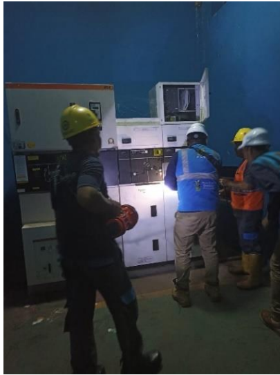
Gambar 2. 13 Pengecekan Kubikel Sumber: (Dokumentasi Pribadi, 2024)
