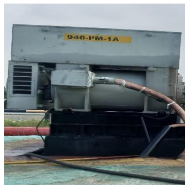
Gambar 4.3 motor listrik pompa transfer 946-pm-1a (Sumber, PT.Pertamina RU II Sei.Pakning)
