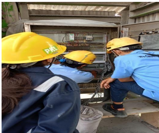
Gambar 2. 9 Terminating kabel ke DCS (sumber ; Dokumentasi di PT. Indah Kiat Pulp and Paper)
