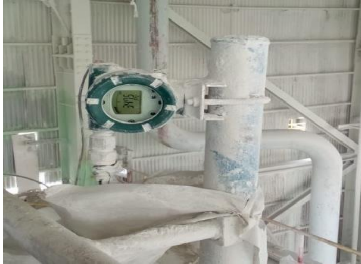
Gambar 3. 1 Temperatur Transmitter (sumber ; Dokumentasi di PT. Indah Kiat Pulp and Paper)
