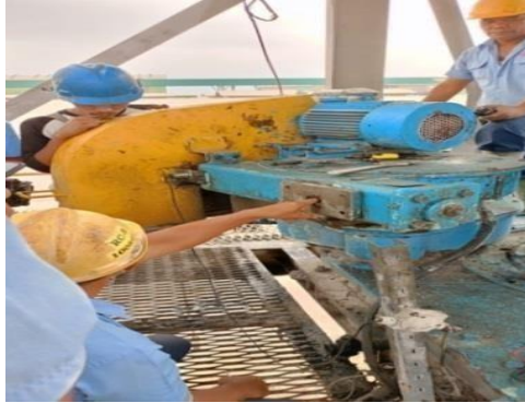
Gambar 2. 11 Bongkar pasang Torsi Transmitter (sumber : Dokumentasi di PT. Indah Kiat Pulp and Paper)
