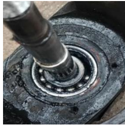
Gambar 4. 14 bearing (6306) yang sudah mengalami kerusakan (Sumber: Dokumen pribadi)
