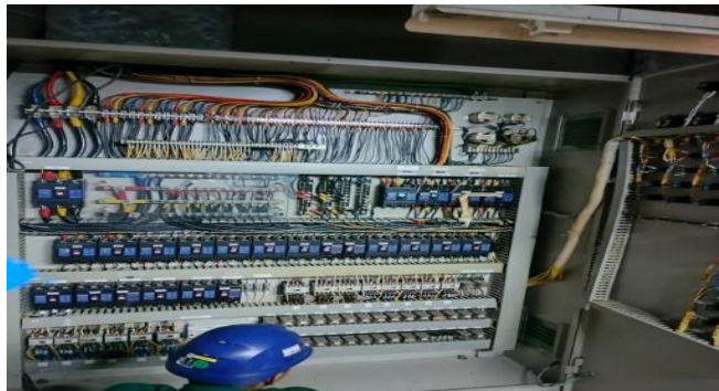
Gambar 2. 43 Pengecekan dan mematikan saklar on pada blower (Sumber: Unit Layanan PLTA Koto Panjang. 2024)
