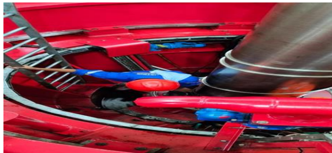
Gambar 2. 10 Maintenance pada Control Level Switch di area Top Cover (Sumber: Unit Layanan PLTA Koto Panjang. 2024)
