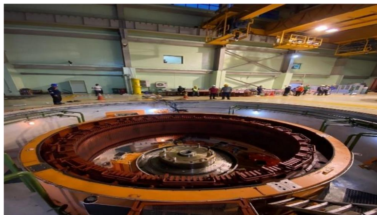
Gambar 3. 4 Stator PLTA Koto panjang (Sumber: Arsip Perusahaan)
