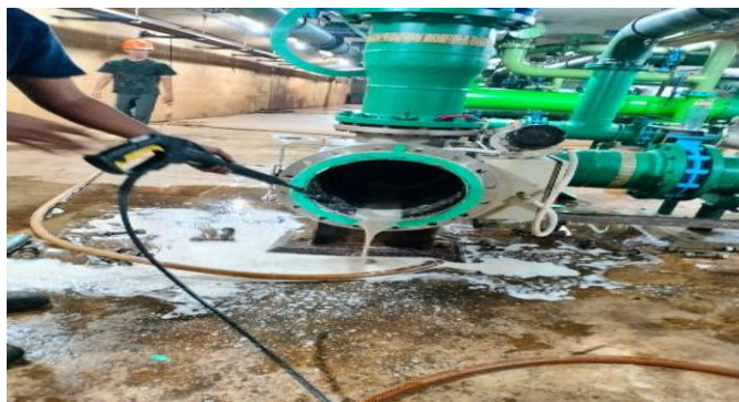
Gambar 2. 49 Maintenance stainer pada unit 3 (Sumber: Unit Layanan PLTA Koto Panjang. 2024)
