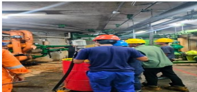
Gambar 2. 53 Pengisian oli cooler pada unit 3 (Sumber: Unit Layanan PLTA Koto Panjang. 2024)
