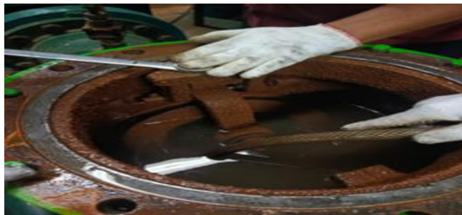
Gambar 2. 20 Pembersihan pada NRV (Sumber: Unit Layanan PLTA Koto Panjang. 2024)
