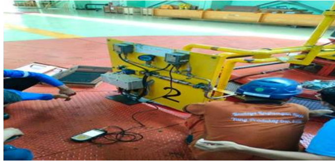
Gambar 2. 37 Pengecekan kebocoran oli pada unit 2 (Sumber: Unit Layanan PLTA Koto Panjang. 2024)
