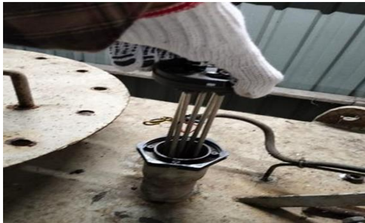
Gambar 3.6 sensor level switch (Sumber: Unit Layanan PLTA Koto Panjang. 2024)
