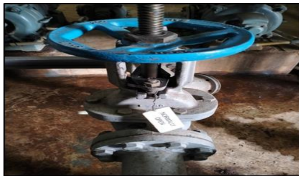
Gambar 3. 16 Gate valve (Sumber: Unit Layanan PLTA Koto Panjang. 2024)
