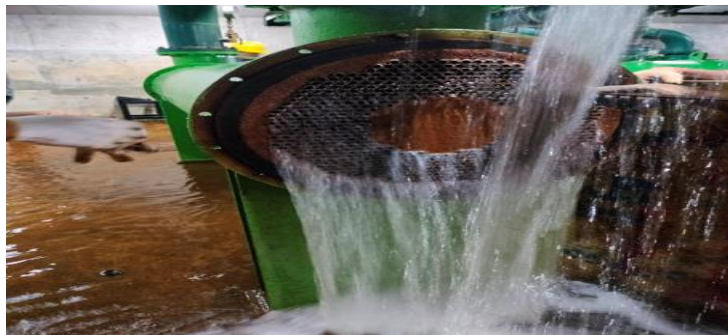
Gambar 2.61 Maintenance HE unit 1 (Sumber: Unit Layanan PLTA Koto Panjang. 2024)
