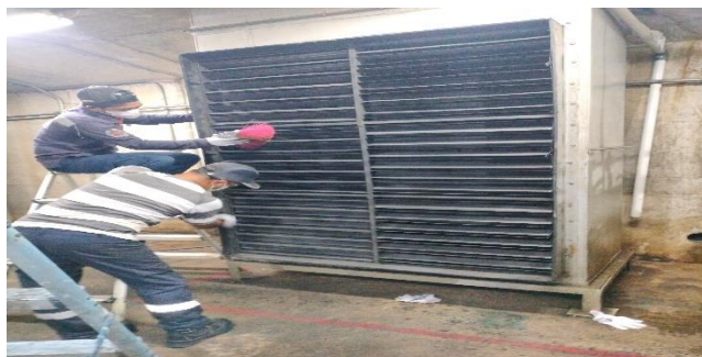
Gambar 2. 41 membersihkan filter vance (Sumber: Unit Layanan PLTA Koto Panjang. 2024)
