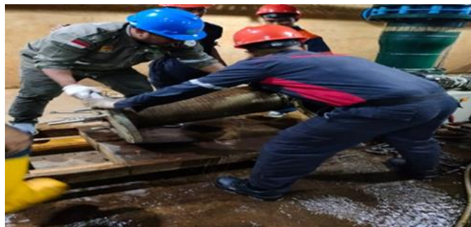
Gambar 2. 38 Pencucian pada raw water rotary stainer (Sumber: Unit Layanan PLTA Koto Panjang. 2024)
