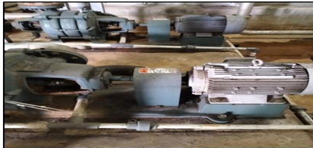
Gambar 3.8 Motor listrik (Sumber: Unit Layanan PLTA Koto Panjang. 2024)
