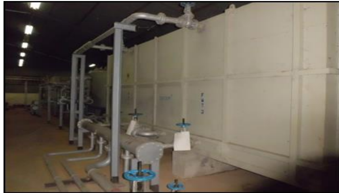
Gambar 3. 22 Fresh water tank (Sumber: Unit Layanan PLTA Koto Panjang. 2024)
