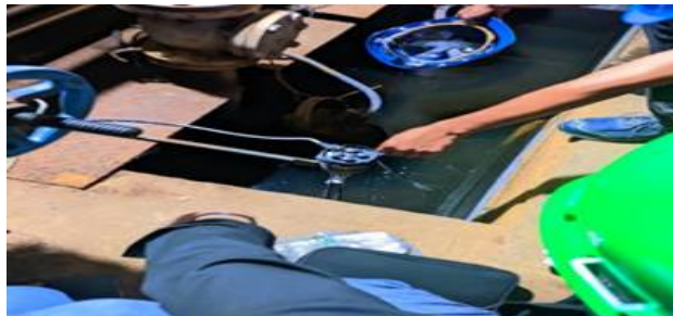
Gambar 2. 13 Maintenance Pengujian Control Level Switch pada sistem Drainage bendungan (Sumber: Unit Layanan PLTA Koto Panjang. 2024)
