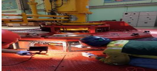
Gambar 2. 12 pembersihan area slip ring (Sumber: Unit Layanan PLTA Koto Panjang. 2024)
