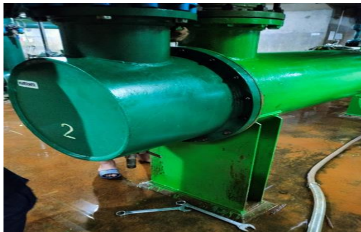
Gambar 2.63 Maintenance HE unit 2 (Sumber: Unit Layanan PLTA Koto Panjang. 2024)
