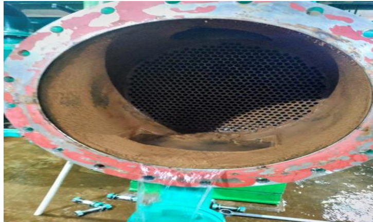
Gambar 2.62 Maintenance HE unit 1 (Sumber: Unit Layanan PLTA Koto Panjang. 2024)
