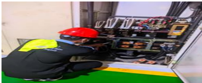
Gambar 2. 18 melakukan pengecekan pada sumber eksitasi (Sumber: Unit Layanan PLTA Koto Panjang. 2024)
