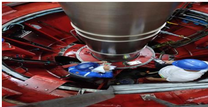
Gambar 2. 35 Pengukuran kecepatan putaran tegangan pada generator (Sumber: Unit Layanan PLTA Koto Panjang. 2024)
