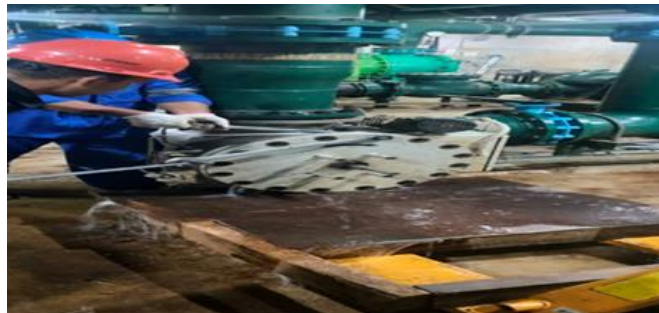
Gambar 2. 25 Pemeliharaan pada raw watter rotari stainer (Sumber: Unit Layanan PLTA Koto Panjang. 2024)
