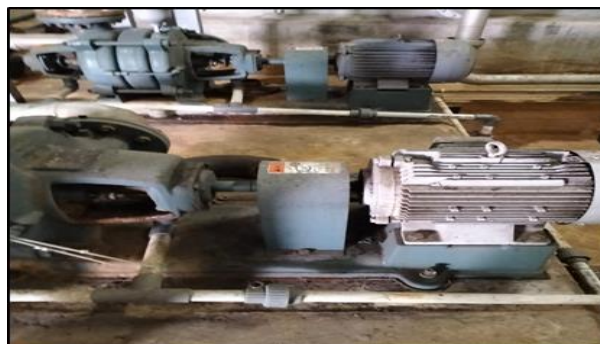
Gambar 3. 17 Motor dan Pompa (Sumber: Unit Layanan PLTA Koto Panjang. 2024)
