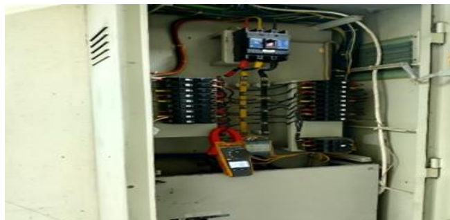
Gambar 2. 23 Pengecekan Pada Panel 23 system penerangan (Sumber: Unit Layanan PLTA Koto Panjang. 2024)
