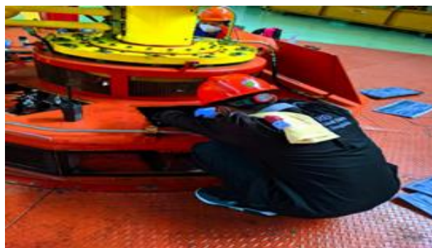
Gambar 2. 11 Pengukuran Carbon Brush pada unit 1 (Sumber: Unit Layanan PLTA Koto Panjang. 2024)
