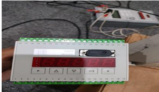
Gambar 2. 34 Alat pengecekan kecepatan putaran generator (Sumber: Unit Layanan PLTA Koto Panjang. 2024)
