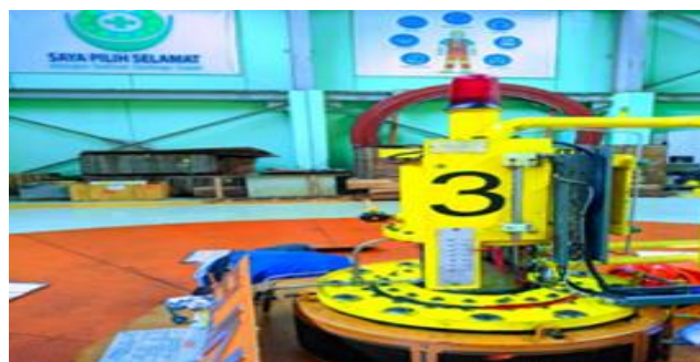
Gambar 2. 16 Maintenance pada carbon brash (Sumber: Unit Layanan PLTA Koto Panjang. 2024)
