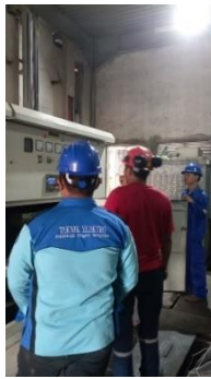
Gambar 2. 36 Troubleshooting Panel Genset 1,8 MW Sumber : (Dokumentasi, 2024)
