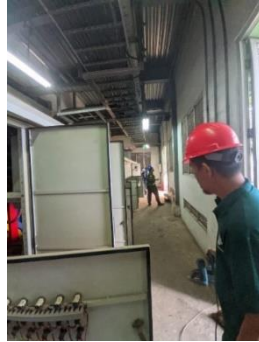
Gambar 2. 20 Cleaning Panel MDB Sumber : (Dokumentasi, 2024)
