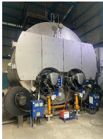
Gambar 3. 1 Boiler Sumber : (PT. Kreasijaya Adhikarya)
