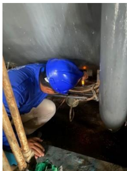
Gambar 2. 4 Mengukur Vibrasi Dan Suhu Pada Refrigerant Pump Chiller Sumber : (Dokumentasi, 2024)
