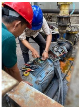
Gambar 2. 33 Perbaikan Terminal Yang Terbakar Sumber : (Dokumentasi, 2024)
