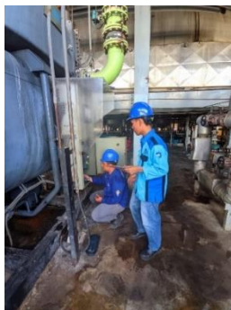
Gambar 2. 3 Pengukuran Voltase Dan Load current Panel Control Chiller A Sumber : (Dokumentasi, 2024)
