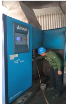
Gambar 2. 15 Membersihkan Electromotor Dan Panel Air Compressor Menggunakan Angin Dari Air Compressor Sumber : (Dokumentasi, 2024)
