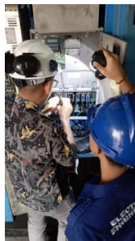
Gambar 2. 24 Cek Wiring Control Pada Panel Air Compressor Sumber : (Dokumentasi, 2024)
