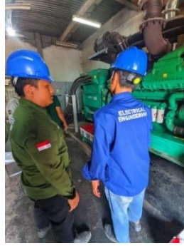
Gambar 2. 40 Mengganti Baterai Genset 1,8 MW Sumber : (Dokumentasi, 2024)
