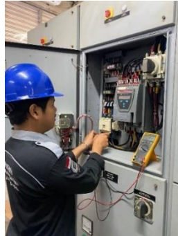
Gambar 2. 7 Pengukuran Voltase Dan Load Current Pada Panel Control Electromotor Refinery Sumber : (Dokumentasi, 2024)
