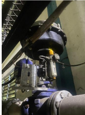
Gambar 3. 9 Control valve pada pipa Gas dan Air Sumber : (PT. Kreasijaya Adhikarya)
