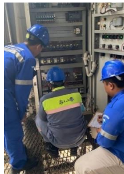
Gambar 2. 6 Pengukuran Arus Pada Panel Control High Pressureboiler Geka Konus Sumber : (Dokumentasi, 2024)
