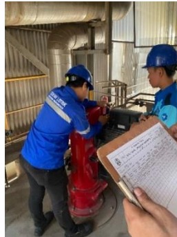
Gambar 2. 5 Pengukuran Vibrasi Dan Suhu Pada Electromotor Blower Boiler Geka Konus Sumber : (Dokumentasi, 2024)
