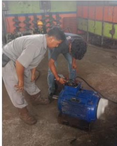
Gambar 2.61 Mencba Motor Pompa Cito Sumber: PTPN IV Sei Buatan
