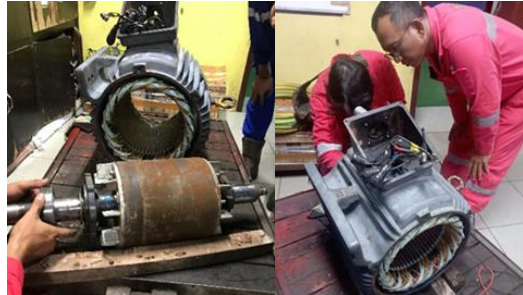
Gambar 2. 25 Cek Motor After Heater (Sumber: Dokumentasi Pribadi 2024)
