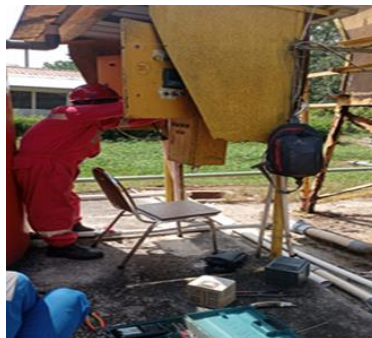
Gambar 2. 48 Pemasangan Program Inverter (Sumber: Dokumentasi Pribadi 2024)
