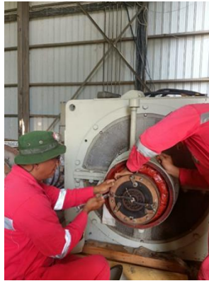
Gambar 2. 43 Megger Generator (Sumber: Dokumentasi Pribadi 2024)
