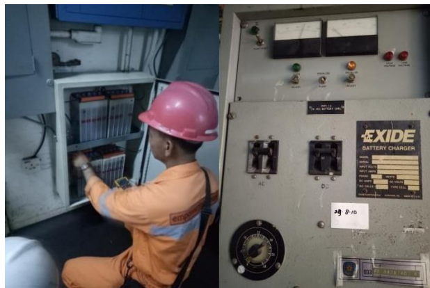
Gambar 2. 67 Monitoring kondisi baterai (Sumber : Dokumentasi pribadi 2024)
