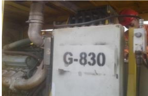
Gambar 2. 68 pemeliharaan emergency genset (sumber:dokumentasi pribadi 2024)
