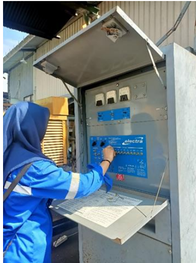
Gambar 2. 30 Disconnect Power Loadbank (Sumber: Dokumentasi Pribadi 2024)
