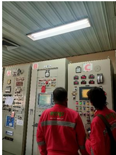
Gambar 2. 27 Start Up Turbin (Sumber: Dokumetasi Pribadi 2024)
