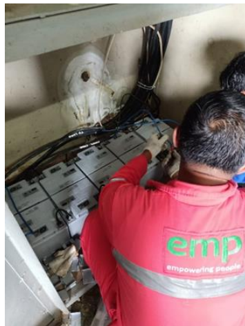
Gambar 2. 32 Pasang Charger Baterai 12V Di AC3 (Sumber: Dokumentasi Pribadi 2024)
