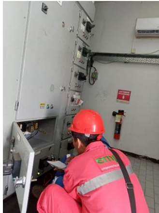
Gambar 2. 35 Megger Breaker Aerator (Sumber: Dokumentasi Pribadi 2024)
