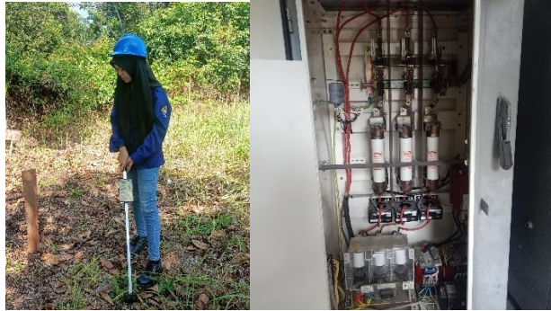
Gambar 2. 3 Check Cable Underground (Sumber: Dokumentasi Pribadi)
