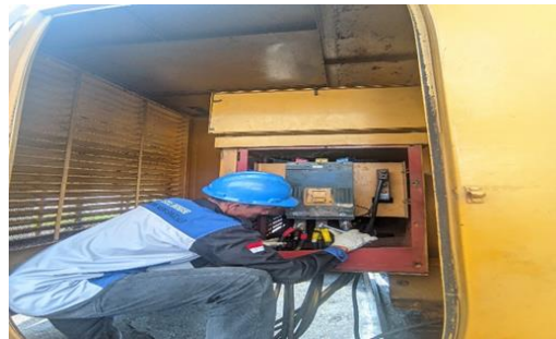
Gambar 2. 15 Tes Beban Generator (Sumber: Dokumentasi Pribadi 2024)
