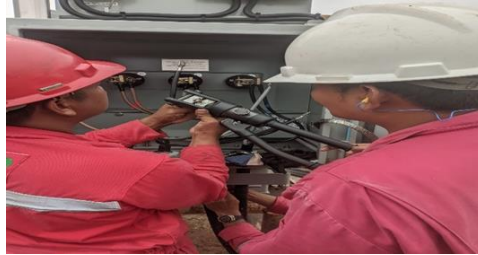
Gambar 2. 14 Termination Kabel (Sumber: Dokumentasi Pribadi 2024)
