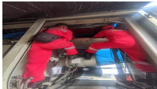
Gambar 2. 19 Connect Kabel Output Generator (Sumber: Dokumentasi Pribadi 2024)
