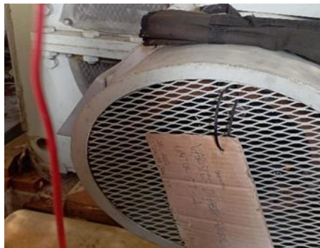
Gambar 2. 55 Check Phase To Phase Generator (Sumber: Dokumentasi Pribadi 2024)
