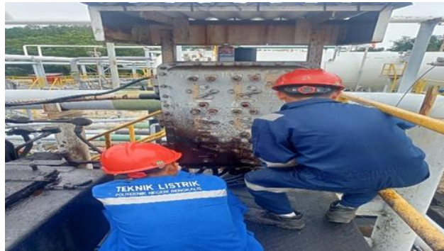
Gambar 2. 7 Troubleshooting Agitator (Sumber: Dokumentasi Pribadi 2024)
