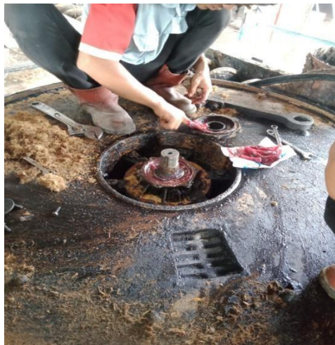
Gambar 2.2 Penambahan Grease pada Bearing Vibrating Screen (sumber : dokumentasi penulis 2024)
