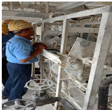
2.27. Ganti Selenoid Valve (Sumber:PT.Indah Kiat Pulp & Paper)
