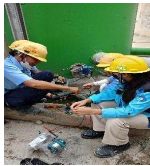
2.15. Ganti Level Transmitter (Sumber:PT.Indah Kiat Pulp & Paper)
