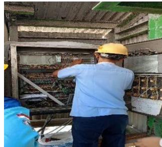
2.19. Servis Kabel Dcs Lapangan
