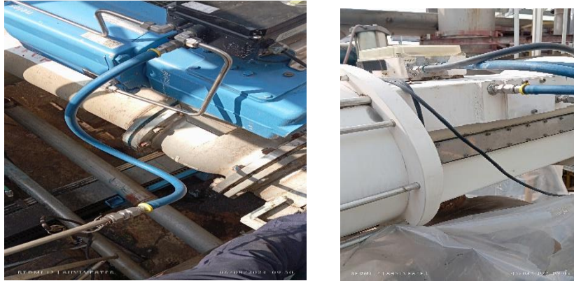
Gambar 2. 13 Gambar Ganti Hose Open, Close, dan Supply pada kontrol Valve (Sumber : Dokumentasi PT. Indah Kiat Pulp & Paper Perawang 2024.).
