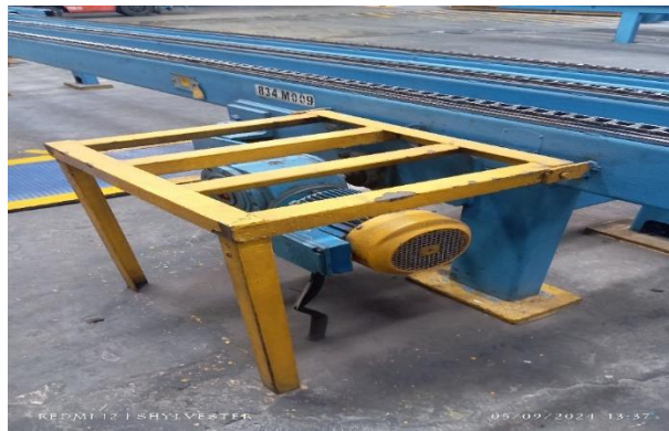
Gambar 3. 3 Gambar Motor 3 fasa yang digunakan di Conveyor
