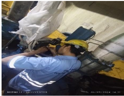
Gambar 2. 6 Melakukan pengecekan Duplikasi Trecing Switch Alarm.
