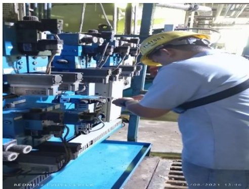
Gambar 2. 22 Gambar Preventive SV yang ada di Hydraulic Section (Sumber : Dokumentasi PT. Indah Kiat Pulp & Paper Perawang 2024.).
