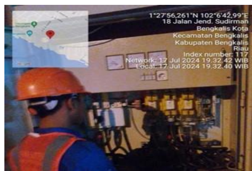
Gambar 2. 23 Pengukuran Beban (Sumber : dokumentasi 2024)
