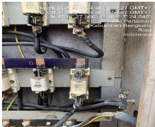
Gambar 3. 4 NH/ NT fuse (Sumber : dokumentasi 2024)
