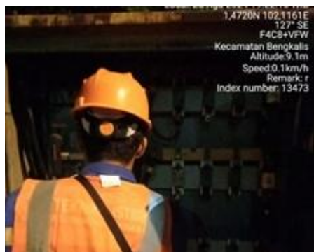
Gambar 2. 47 Pengukuran beban (Sumber : dokumentasi 2024)
