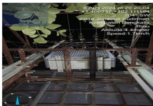
Gambar 2. 36 Gangguan Pada trafo (Sumber : dokumentasi 2024)
