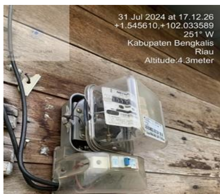
Gambar 2. 30 Gangguan pada KWH pelanggan (Sumber : dokumentasi 2024)
