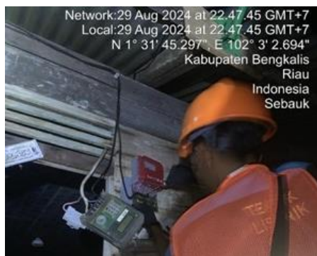
Gambar 2. 49 Gangguan pada KWH meter (Sumber : dokumentasi 2024)
