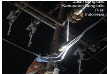
Gambar 2. 50 Gangguan Pada SR ( saluran rendah) (Sumber : dokumentasi 2024)
