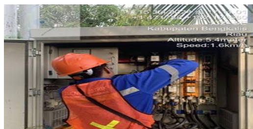
Gambar 2. 21 Pengukuran beban (Sumber : dokumentasi 2024)
