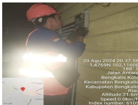
Gambar 2. 44 Gangguan pada KWH meter (Sumber : dokumentasi 2024)
