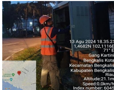
Gambar 2. 39 Pengukuran beban (Sumber : dokumentasi 2024)
