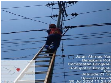
Gambar 2. 29 Ganguan pada SR ( Saluran rendah) (Sumber : dokumentasi 2024)
