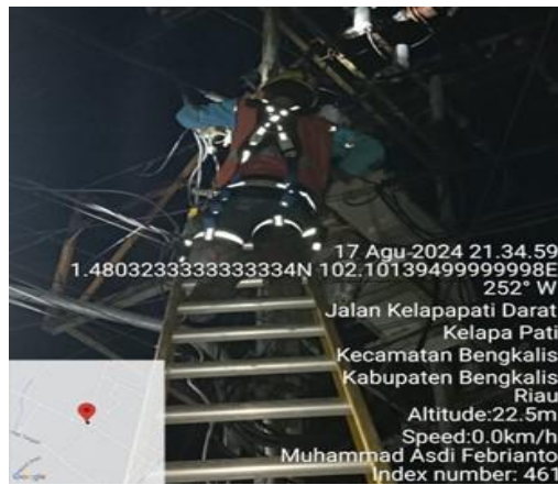
Gambar 2. 41 Gangguan Pada SR (saluran rendah) (Sumber : dokumentasi 2024)
