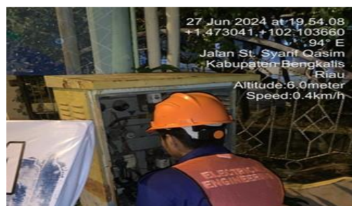
Gambar 2. 12 Pengukuran beban (Sumber : dokumentasi 2024)
