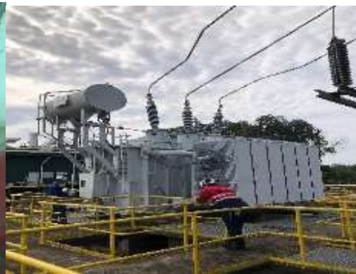
Pengecekan Pada Switchard
