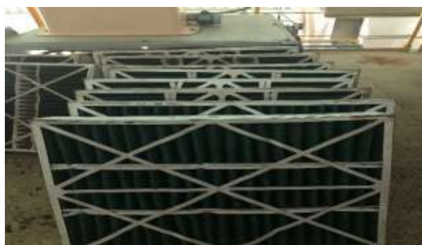
Pemasukan Saringan Turbin
