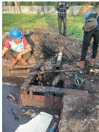
Gambar 2. 8 Pengecekan Pompa Sedimentasi
