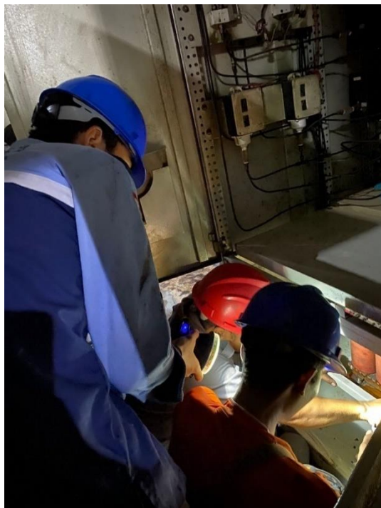
Perawatan panel yang terkena air hujan
