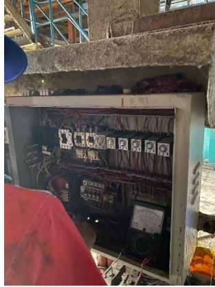
Gambar 2.1 Pengecekan Motor IDF
