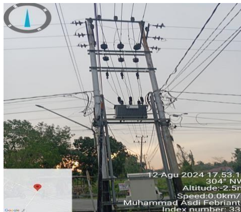
Gambar 2.41 Pengecekan Trafo (Sumber : dokumentasi 2024)
