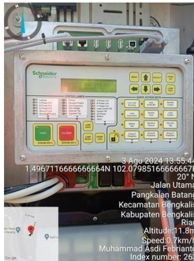
Gambar 3.1 Recloser (RC) (Sumber : dokumentasi 2024)
