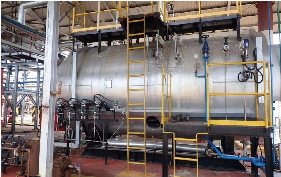
Gambar 3.1 Boiler PT. Pertamina Internasional RU II Sungai Pakning
