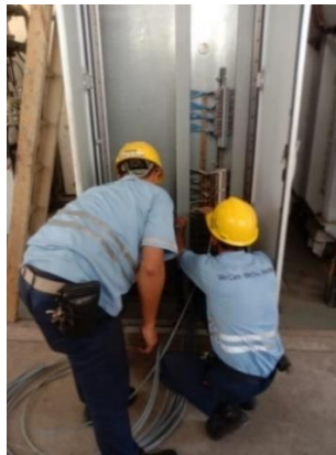
Gambar 2.27 Pemasangan Kabel Kontrol Rectifier (Sumber: Dokumentasi, 2024)
