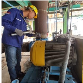
Gambar 2.28 Perawatan Motor DC (Sumber: Dokumentasi, 2024)
