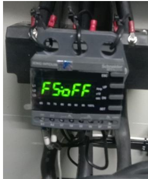
Gambar 3.11 EOCR Fail Safe Off (Sumber: Dokumentasi, 2024)
