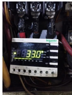
Gambar 3.8 Nilai Arus Fasa S (Sumber: Dokumentasi, 2024)
