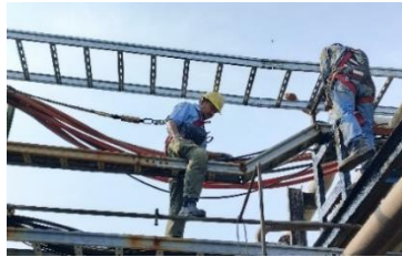
Gambar 2.12 Perawatan Kabel Tray (Sumber: Dokumentasi, 2024)
