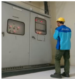
Gambar 2.22 Pemeriksaan Rectifier (Sumber: Dokumentasi, 2024)
