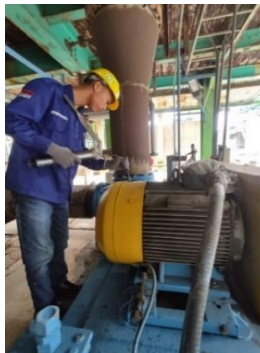
Gambar 2.9 Perawatan Motor DC (Sumber: Dokumentasi, 2024)
