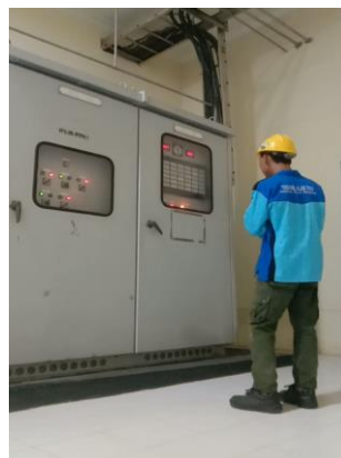
Gambar 2.2 Pemeriksaan Rectifier (Sumber: Dokumentasi, 2024)
