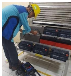
Gambar 2.17 Pemeriksaan Bulanan Battery Backup (Sumber: Dokumentasi, 2024)
