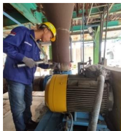
Gambar 2.10 Perawatan Motor DC (Sumber: Dokumentasi, 2024)
