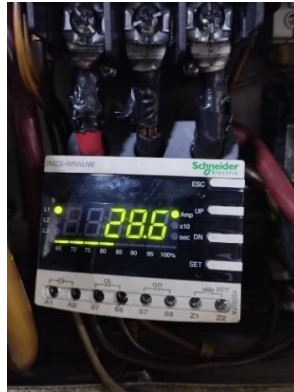
Gambar 3.7 Nilai Arus Fasa R (Sumber: Dokumentasi, 2024)
