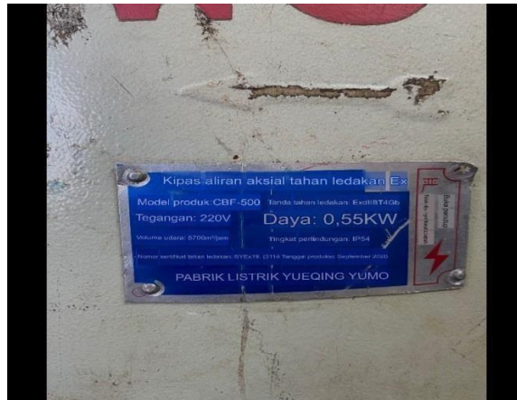
Gambar 3.4 2 Nameplate Motor Blower 1 Phasa (Sumber: Unit Pertamina Sei Pakning 2024 )
