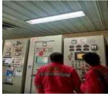
Gambar 2. 39 Start Up GT-B Dan GT-C (Sumber: Dokumentasi Pribadi 2024)
