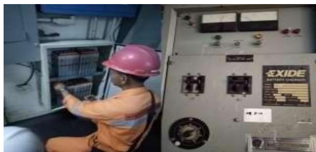
Gambar 2. 67 Monitoring kondisi baterai
