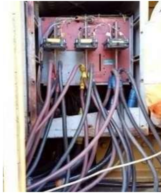
Gambar 2. 69 pemeliharaan emergency genset (Sumber : Dokumentasi pribadi 2024)
