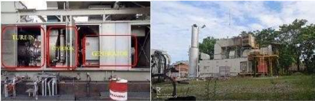
Gambar 3.1 1 Generator (Sumber : Dokumentasi)
