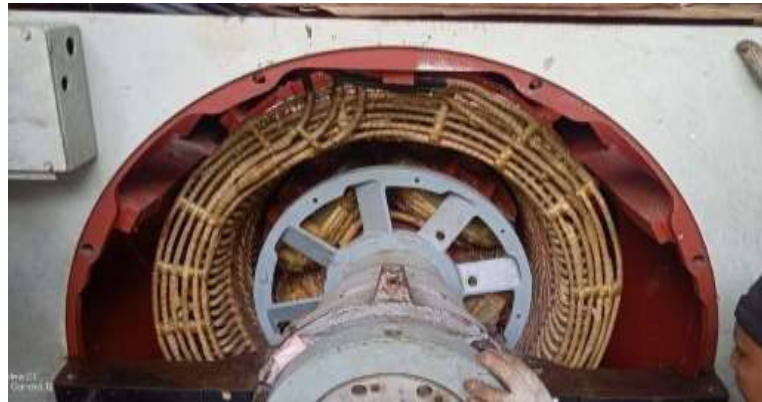
Gambar 3.1 4 Stator generator (Sumber : Dokumentasi)
