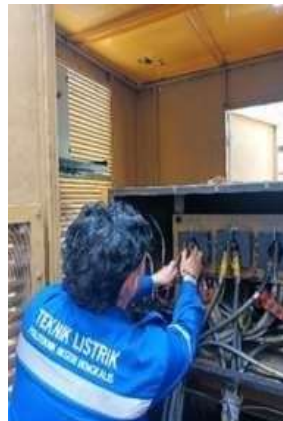
Gambar 2. 21 Connect Kabel Power Untuk Capability Test
