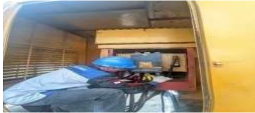
Gambar 2. 15 Tes Beban Generator (Sumber: Dokumentasi Pribadi 2024)
