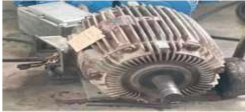
Gambar 2. 57 Cek Kondisi Motor (Sumber: Dokumentasi Pribadi 2024)
