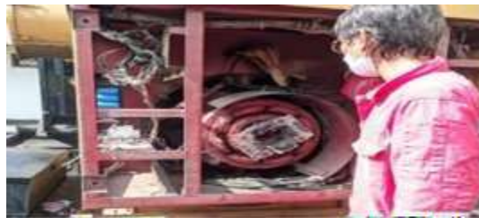
Gambar 2. 59 Servis Genset (Sumber: Dokumentasi Pribadi 2024)
