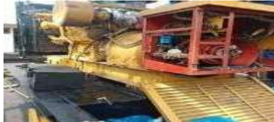
Gambar 2. 29 Servis Genset (Sumber: Dokumentasi Pribadi 2024)
