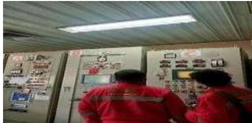
Gambar 2. 27 Start Up Turbin (Sumber: Dokumentasi Pribadi 2024)
