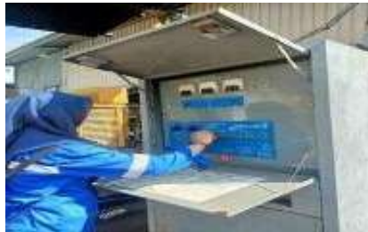
Gambar 2. 30 Disconnect Power Loadbank (Sumber: Dokumentasi Pribadi 2024)
