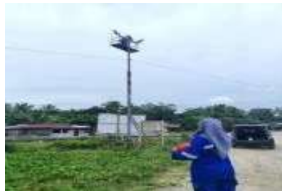
Gambar 2. 34 Survey Lighting (Sumber: Dokumentasi Pribadi 2024)
