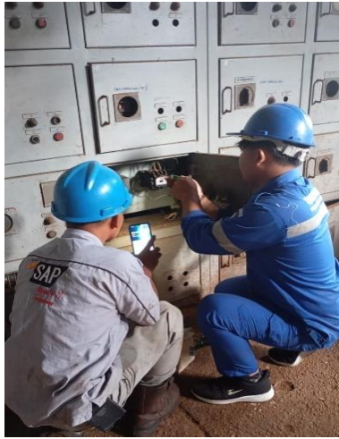
Gambar 2. 64 Memasang kontaktor pada panel ripple mill (Sumber: Dokumentasi di PTPN IV Sei Buatan,2024)
