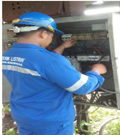
Gambar 2. 23 Mengecek/mengukur arus listrik pada panel limbah (Sumber: Dokumentasi di PTPN IV Sei Buatan,2024)
