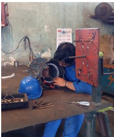
Gambar 2. 9 Pemasangan lilitan email drat pada stator elmot (Sumber: Dokumentasi di PTPN IV Sei Buatan,2024)
