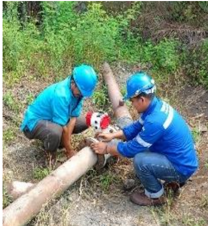
Gambar 2. 2 Memasang flowmeter pada pipa waduk (Sumber: Dokumentasi di PTPN IV Sei Buatan,2024)
