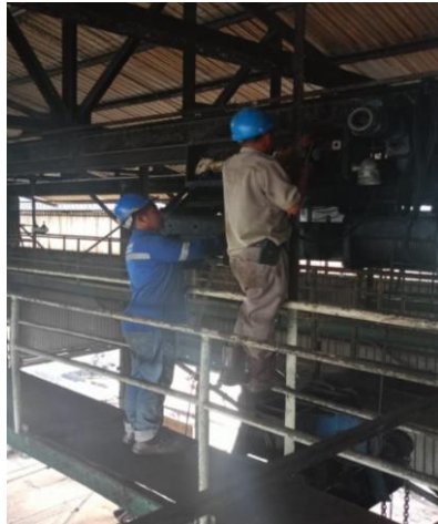
Gambar 2. 10 Mengecek kerusakan kontaktor pada hoist crane (Sumber: Dokumentasi di PTPN IV Sei Buatan, 2024)
