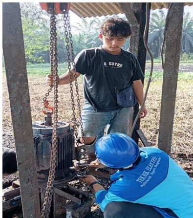
Gambar 2. 50 Memasang elmot pada pompa limbah (Sumber: Dokumentasi di PTPN IV Sei Buatan, 2024)
