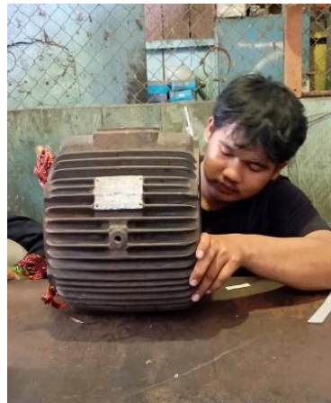
Gambar 2. 31 Memasang gulungan/lilitan email drat ke stator elmot (Sumber: Dokumentasi di PTPN IV Sei Buatan,2024)
