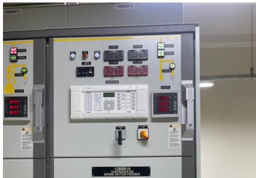
Gambar 3.4 Controll Panel Sumber:(Dokumentasi , 2024)
