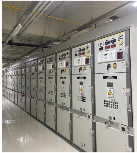
Gambar 3.1 Switchgear MV Sumber:(Dokumentasi , 2024)
