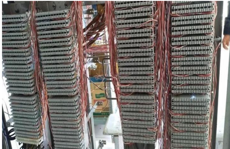
Gambar 4.15 Terminal Kabel Penyambung dari PABX
