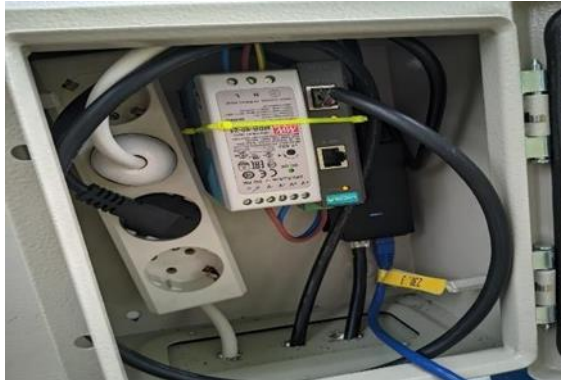
Gambar 3.11 Perakitan Box Power Radio Link
