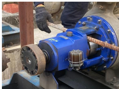
Gambar 4 8 Pembuangan Fluida Pompa
