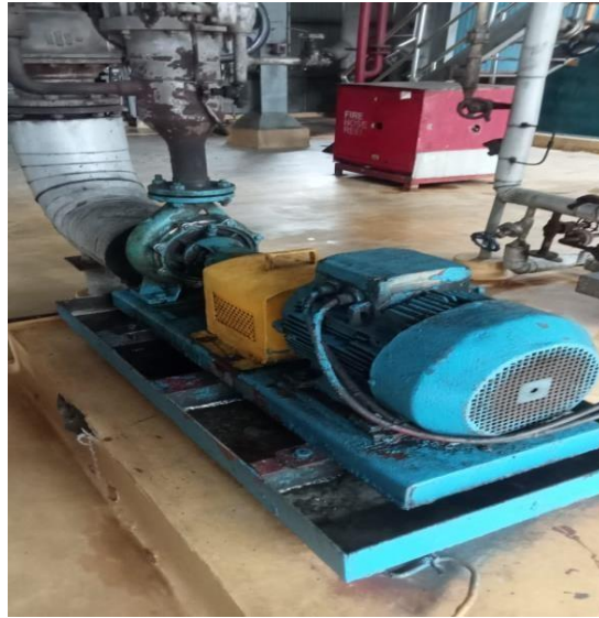
Gambar 4.9 Pompa Distilasi PU 6G02 A
