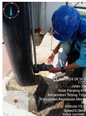
Gambar 2. 8 Pengecekan Resitansi Pertahanan Pada Trafo Menggunakan Alat Earth Clamp (Sumber: PT. PLN PERSERO ULP Selatpanjang)
