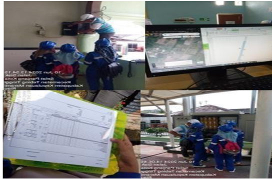
Gambar 2. 7 Pengecekan Tegangan Pada Trafo RST (Sumber: PT. PLN PERSERO ULP Selatpanjang)
