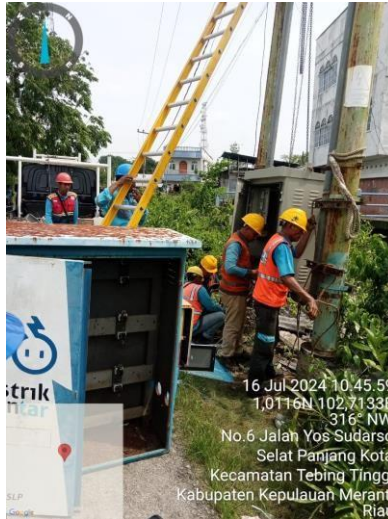
Gambar 2. 14 Pemeliharaan pada PHBTR (Sumber: PT. PLN PERSERO ULP Selatpanjang)
