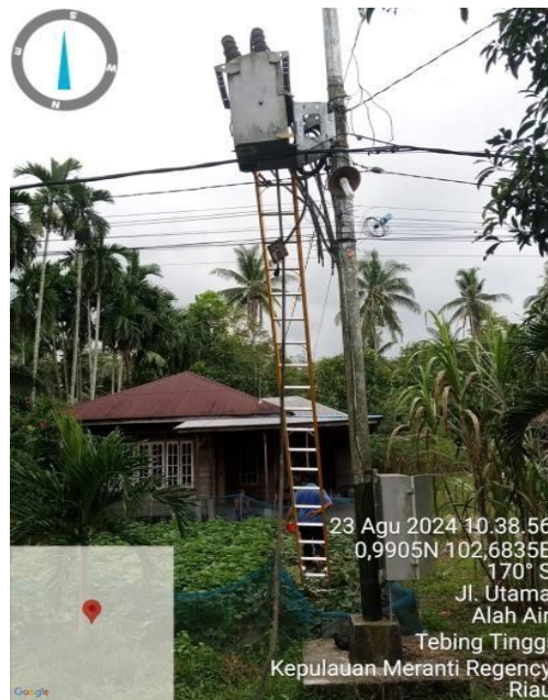
Gambar 2. 23 Pengecekan RC (Sumber: PT. PLN PERSERO ULP Selatpanjang)
