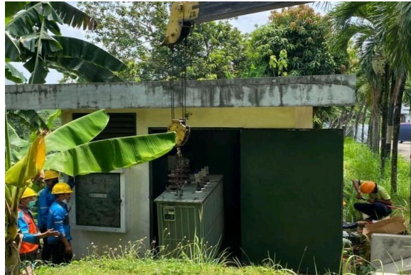
Gambar 3. 6 Gardu Beton (Sumber: PT. PLN PERSERO ULP Selatpanjang)
