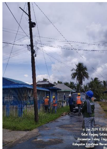
Gambar 2. 4 Memperbaiki 3 Andongan Tiang Dan Meluruskan Tiang Yang Condong Pada TM2 (Sumber: PT. PLN PERSERO ULP Selatpanjang)
