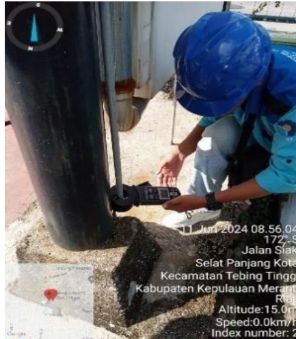
Gambar 2.8 Pengecekan Resistansi Pertahanan Trafo menggunakan alat Earth Clamp (Sumber: PT. PLN Persero ULP Selatpanjang)
