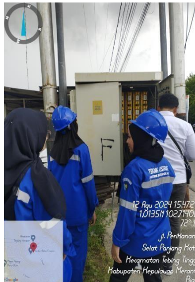
Gambar 2.19 Manufer Tegangan kegiatan Pengecekan Trafo nilai R S T untuk penyediaan beban pelanggan (Sumber: PT. PLN Persero ULP Selatpanjang)
