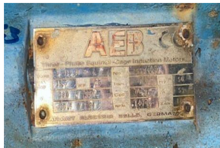
Gambar 3.1 Nameplate motor fin fan 3 phasa ( Sumber : Unit Pertamina Sei Pakning 2024)
