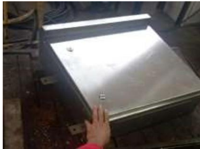
Gambar 2. 54 Install Penbook Untuk Panel Sumber: Data Olahan 2024
