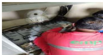
Gambar 2. 32 Pasang Charger Baterai 12V Di AC3
