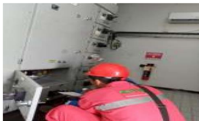
Gambar 2. 35 Megger Breaker Aerator Sumber: Data Olahan 2024
