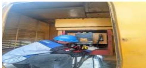
Gambar 2. 15 Tes Beban Generator Sumber: Data Olahan 2024
