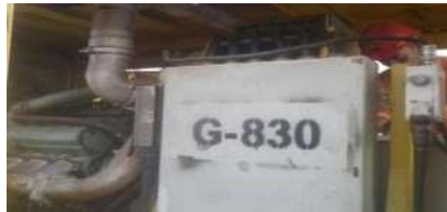
Gambar 2. 67 pemeliharaan emergency genset sumber:Data Olahan 2024
