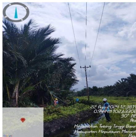
Gambar 4. 1 Penebangan Ranting Pohon Jaringan Distribusi (Sumber: PT PLN. (Persero) ULP Selat Panjang)
