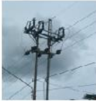
Gambar 2. 4 Contoh Letak Pemasangan Load Break Switch (LBS) (Sumber: PT PLN. (Persero) ULP Selat Panjang)
