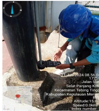
Gambar 2. 8 Pengecekan Resistansi Pertahanan Pada PHBTR (Sumber: PT PLN. (Persero) ULP Selat Panjang)
