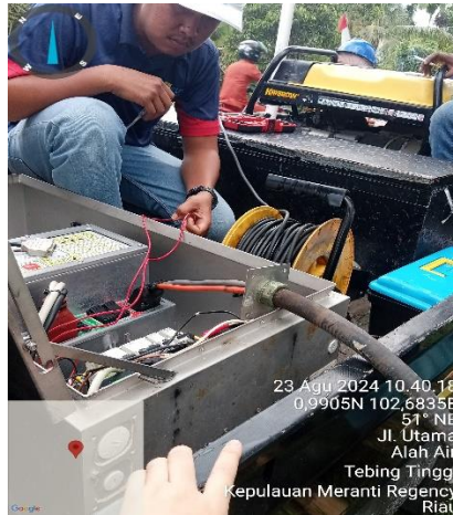
Gambar 2. 36 Pengoperasian Panel Boks Recloser (Sumber: PT PLN. (Persero) ULP Selat Panjang)
