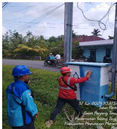
Gambar 2. 9 Peringatan Bahaya Listrik Tegangan Tinggi (Sumber: PT PLN. (Persero) ULP Selat Panjang)
