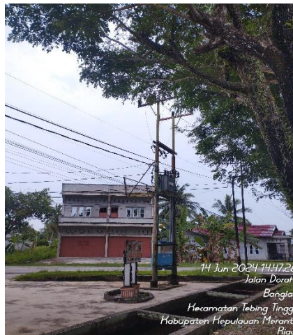
Gambar 2. 11 Inspeksi Jaringan (Sumber: PT PLN. (Persero) ULP Selat Panjang)
