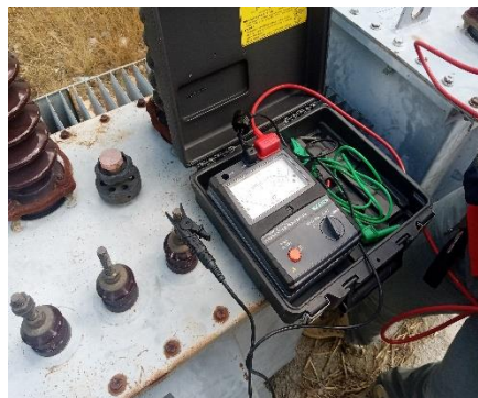
Gambar 2. 3 Mengukur tegangan Trafo (Sumber: PT PLN. (Persero) ULP Selat Panjang)
