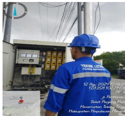
Gambar 2. 29 Pemeliharaan PHBTR (Sumber: PT PLN. (Persero) ULP Selat Panjang)
