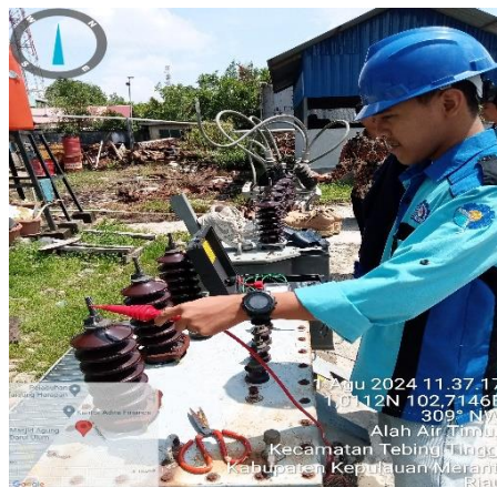
Gambar 2. 27 Pengecekan arus di Trafo (Sumber: PT PLN. (Persero) ULP Selat Panjang)
