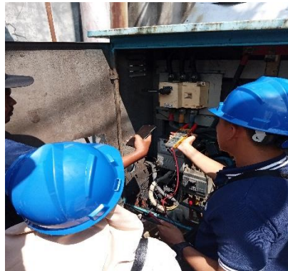
Gambar 2. 5 pengecekan tegangan pada PHBTR (Sumber: PT PLN. (Persero) ULP Selat Panjang)
