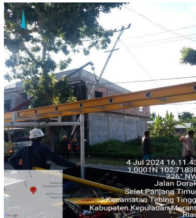
Gambar 2. 20 Pergeseran Gardu Cantol (Sumber: PT PLN. (Persero) ULP Selat Panjang)
