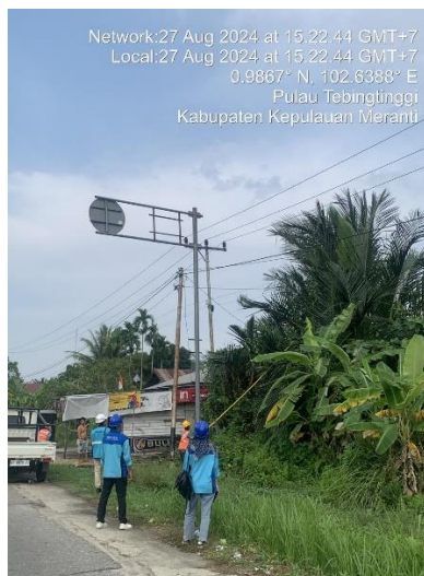
Gambar 2. 37 Inspekta Pemotongan Dahan Pohon (Sumber: PT PLN. (Persero) ULP Selat Panjang)
