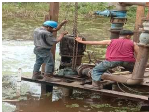
Gambar 2. 51 mengganti elmot untuk pompa waduk (sumber: PTPN IV Regional III)
