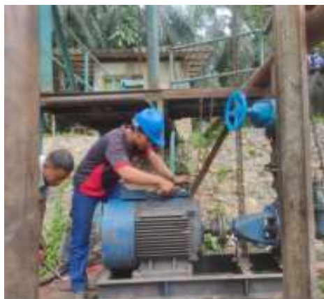
Gambar 2. 46menggantikan elmot waduk (sumber: PTPN IV Regional III)
