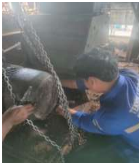
Gambar 2. 49 menggantikan elmot pada ripple mill (sumber: PTPN IV Regional III)
