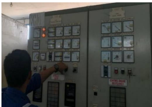
Gambar 2.1 Salah satu panel yang sedang beroperasi (Sumber: dokumentasi, 2024)
