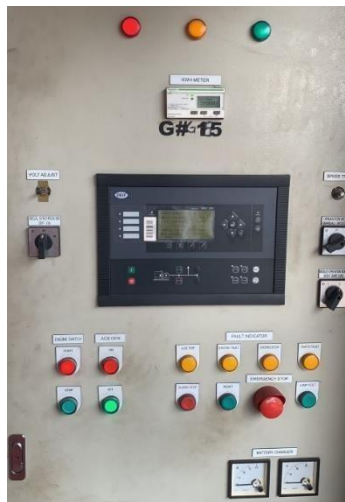
Gambar 3.1 panel listrik (sumber: dokumentasi, 2024)
