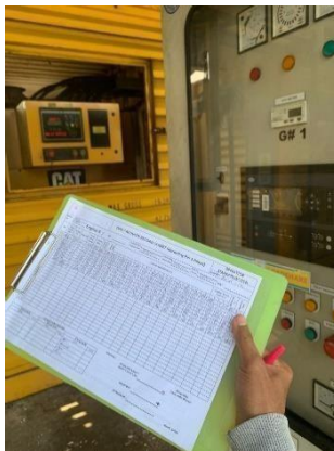
Gambar 2.4 pendataan kwh meter melalui panel mesin
