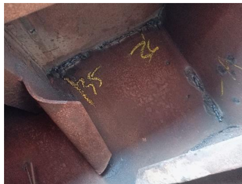
Gambar 2. 29 Kebocoran pada tanki 11
