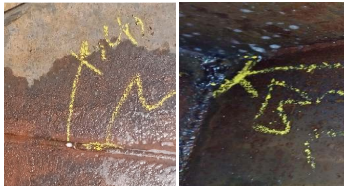
Gambar 3.17. Marking seam joint yang bocor (eksternal dan Internal)
