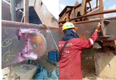
Gambar 2.12 Penetrant Test kupingan Tongkang 176
