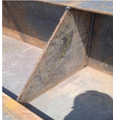
Gambar 2. 62 miss welding pada braket
