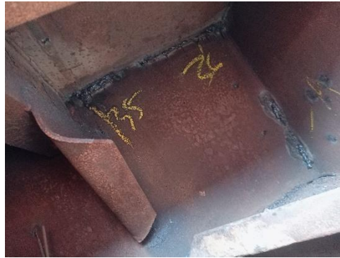
Gambar 2. 26 Kebocoran pada tanki
