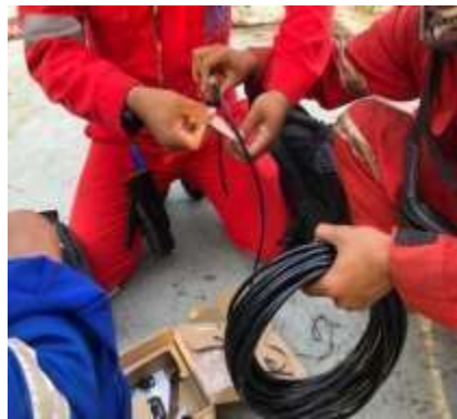
Gambar 3.4 sambung selang ke gas detector
