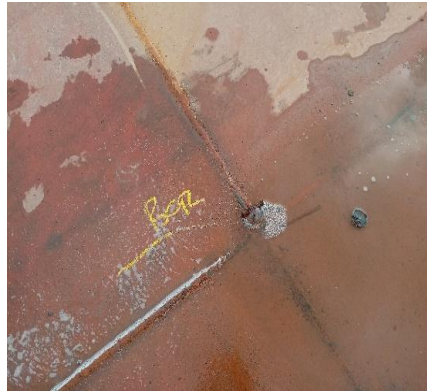
Gambar 2, 19 Marking pada bagian yang bocor saat airtest
