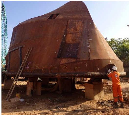
Gambar 2, 2 uji NDT pada kupingan head hull 065
