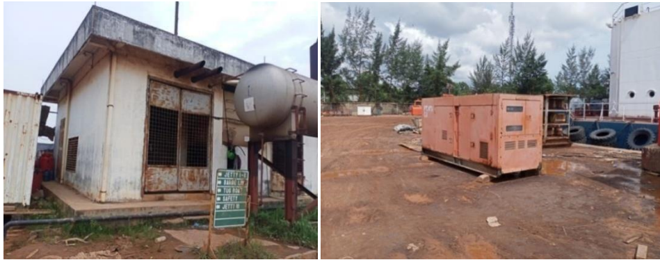
Gambar 1. 7 Generator set dan listrik PLN
