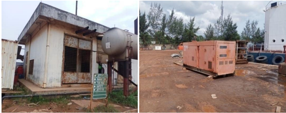
Gambar 1. 7 Generator set dan listrik PLN
