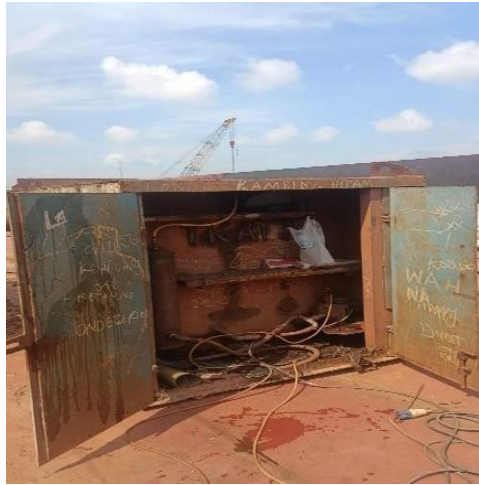
Gambar 3. 4 Mesin pompa air dan tabung air
