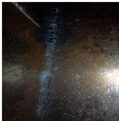
Gambar 3. 15 Area yang bocor
