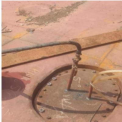
Gambar 3. 11 selang dari compressor koneksi pada flens pipa Sumber Penulis Sumber Penulis
