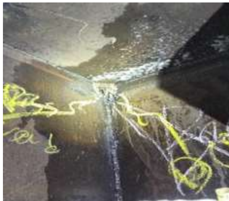
Gambar 2. 59 Kebocoran pada joinan Long bulkhead dan Trans bulkhead
